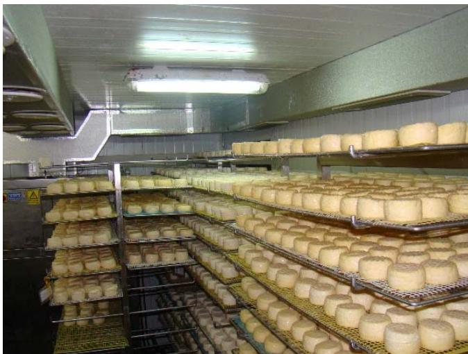
Figura 2.13: Câmara de cura com condutas e com evaporador lateral
