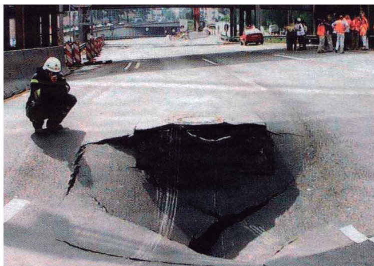
Figura 13 – Colapso de uma faixa de rodagem devido a uma rotura de água.
